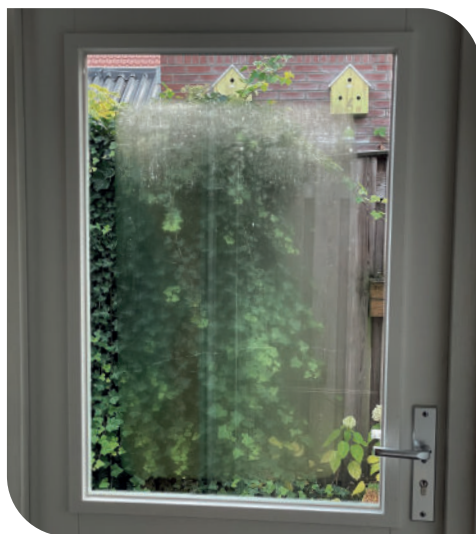
Condensvorming aan de kamerzijde.
